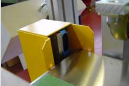
Abb. 5: Lichttaster (Vorabschaltpunkt) im Bereich der Vorzentrierung
